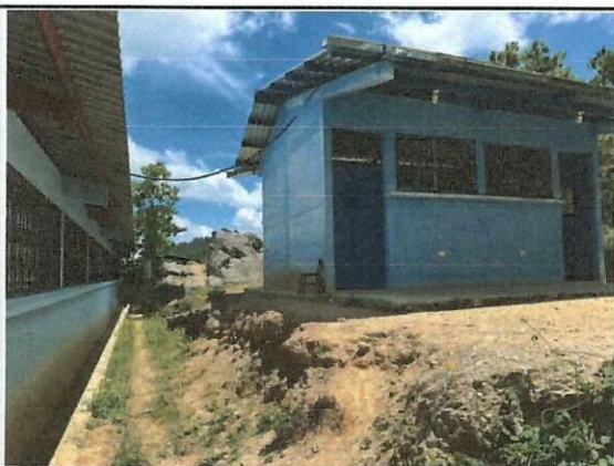
Foto 3: ÁREA DE RIESGO PARA LOS NIÑOS POR LO QUE SE NECESITA UN MURO DE CONTENCIÓN
